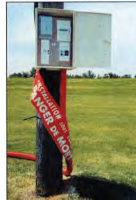
Réseau aérien : au bas du poteau.
