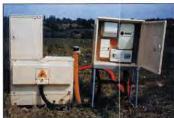
Réseau souterrain : à côté du coffret de réseau.
