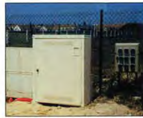
Armoire Tarif-Jaune, en plein réseau.
